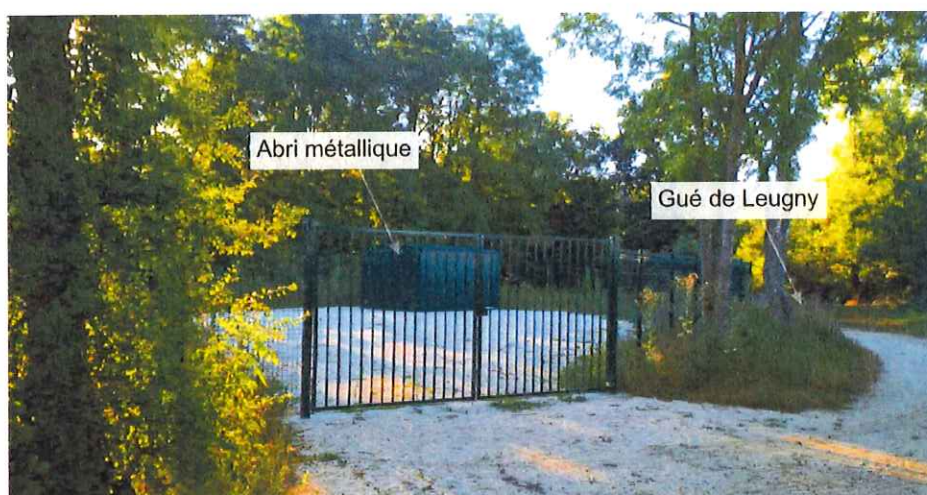
Figure 7 : PPI et abri métallique qui coiffe le forage F2.
